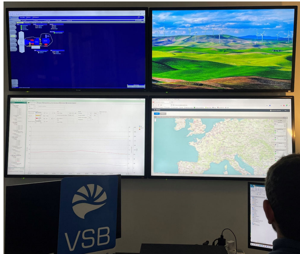
Figure 9 : Photo des 3 tableaux d'affichages correspondant aux SCADA Enercon, Vestas et Nordex (source : VSB)
